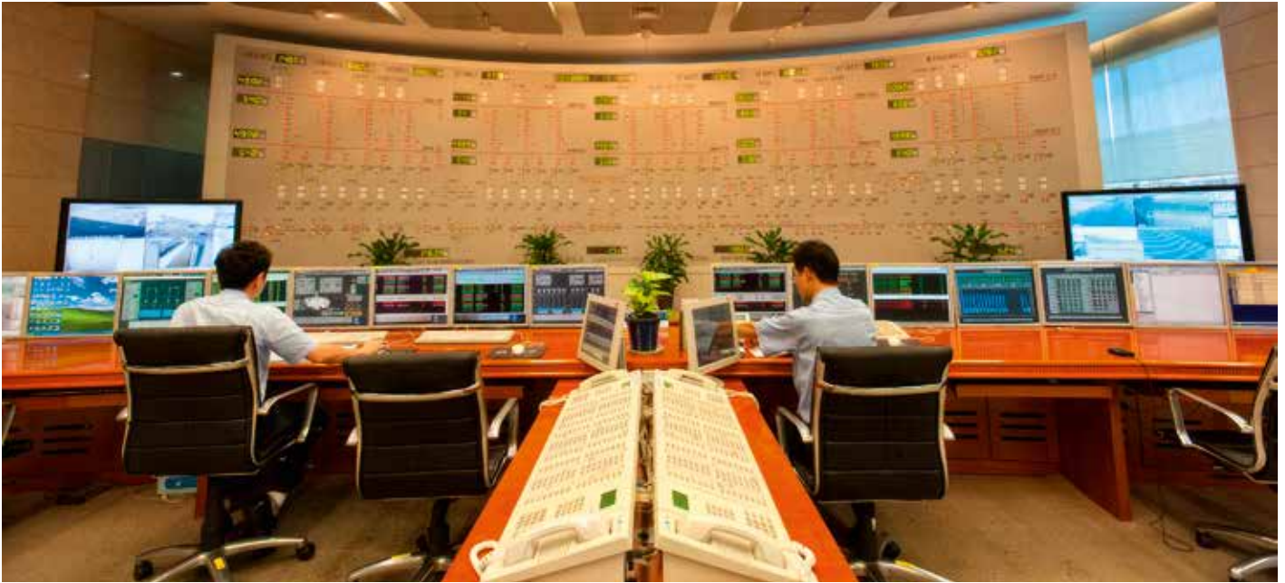
📷 Центральная диспетчерская электростанции Санься
